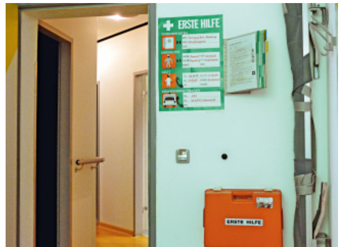
Erste Hilfe-Material – gut sichtbar und leicht erreichbar
